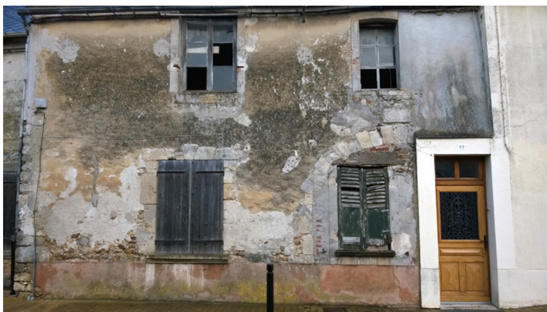
Vue d'une façade décrépie révélant des reprises dans un bâtiment du XVII e siècle
